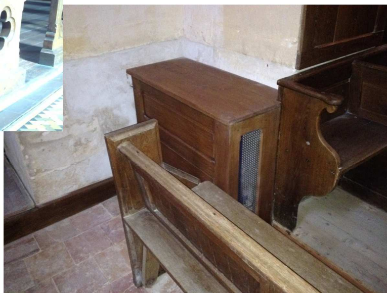
Intégration des transformateurs dans le mobilier
